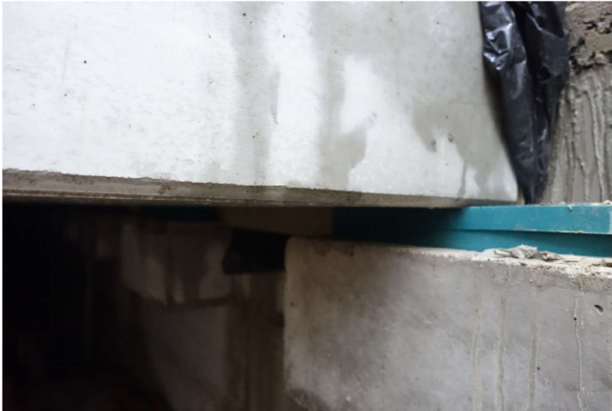
Bild 3: Oberer Lagerstreifen gegenüber dem unteren verdreht eingebaut.
